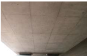
写真-1 点検写真の例
