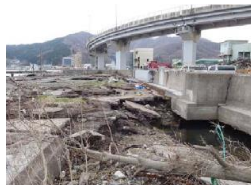
写真-1 海岸保全施設の被災事例 (海側に洗掘された事例：釜石港海岸須賀地区)
