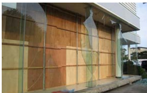
写真1 地震によるガラススクリーンの被害
