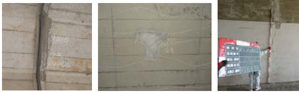
(a) 断面修復工 (b) 表面保護工 図-3 補修箇所の再劣化の例(カルバート)
