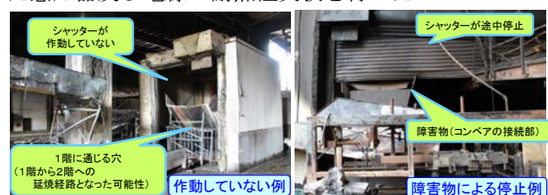
図2 防火シャッターの閉鎖障害の発生状況
