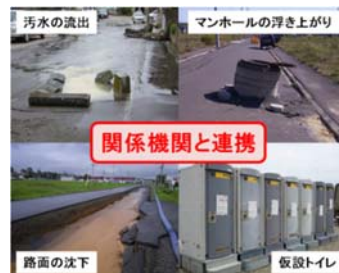
写真-1 下水道施設被災時の例
