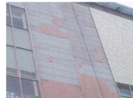
写真-1 押出成形セメント板のタイル仕上げ剥落
