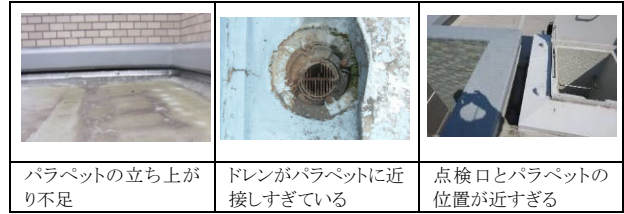
写真-1 設計上の問題があり改修時に防水保証ができない事例
