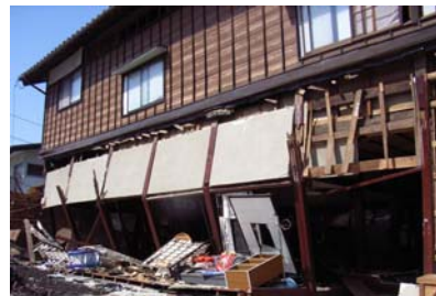
写真4 柱が折損するような甚大な被害を受けた木造家屋 Photo 4. Wooden Houses Severely Damaged by Breakage of their Columns
