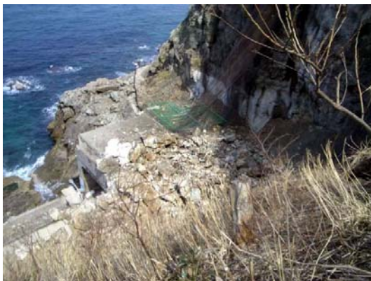
写真 1 岩盤の崩落地付近から見た八世乃洞門の被災状況
