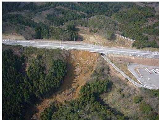
写真 2 別所岳 SA 近傍の盛土崩壊（能登有料道路 17.7kp 七尾市中島町田岸）
