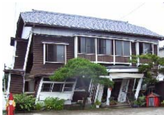
写真-4 大破した木造家屋（柏崎市東本町） Photo 4. Severely damaged wooden home (Higashihoncho in Kashiwazaki City)
