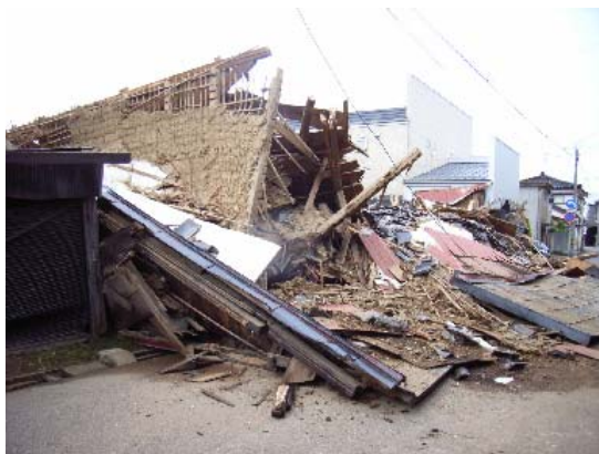
写真-3 倒壊した古い木造家屋（柏崎市四谷） Photo 3. Collapsed old wooden building (Yotsuya in Kashiwazaki City)
