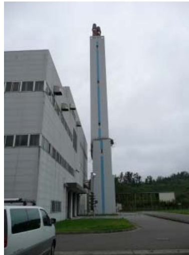
写真-6 大きな被害を受けた鉄筋コンクリート造の煙突 Photo 6. Severely damaged reinforced concrete chimney
