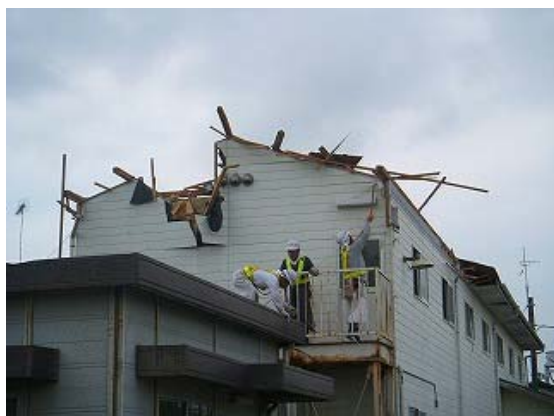
写真3 小屋組の被害（館林市） Photo 3 Damage to roofing frame (Tatebayashi city)
