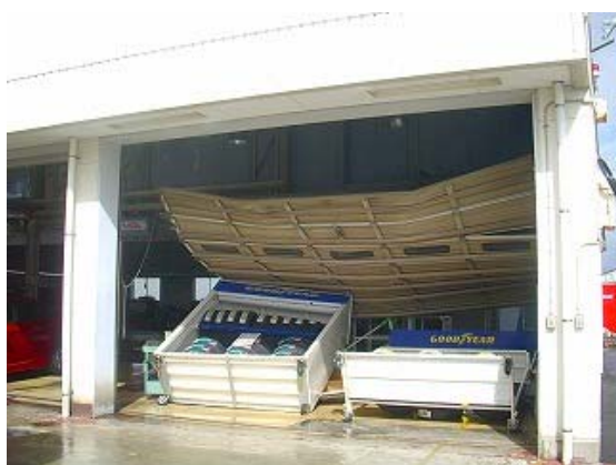
写真5 開口部の被害（土浦市） Photo 5 Failure of dominant opening (Tsuchiura city)
