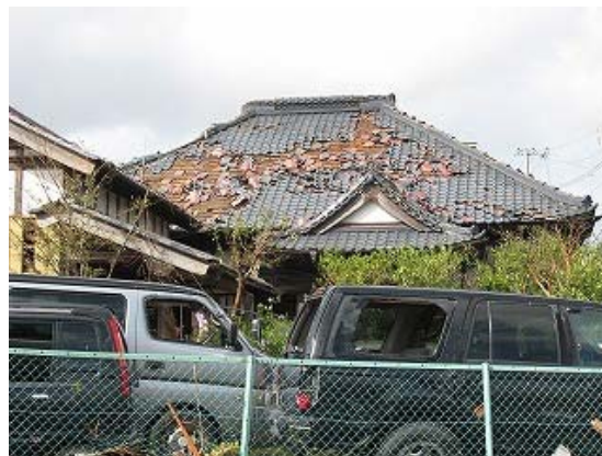
写真4 粘土瓦の移動（土浦市） Photo 4 Movement of clay tiles (Tsuchiura city)
