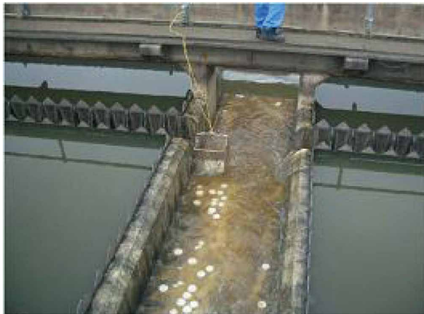
固形塩素による初期段階の消毒の状況
