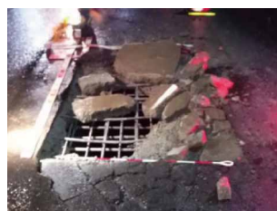
床版抜け落ちの事例
