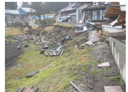
写真 崩壊した石垣
