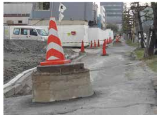
写真 液状化によるマンホール浮上
