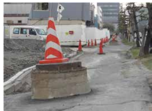
写真 液状化によるマンホール浮上
