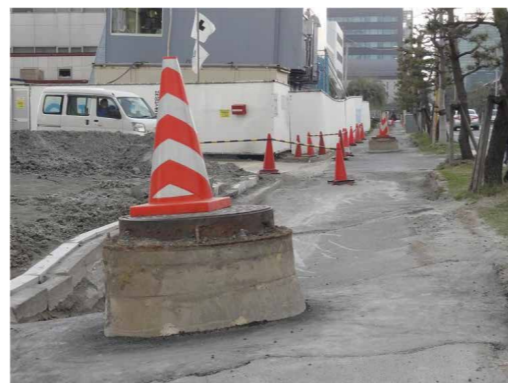
写真 液状化によるマンホール浮上
