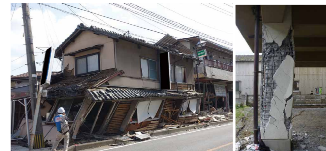
写真 建築物の被害状況 (左: 木造 / 右: RC 造)
