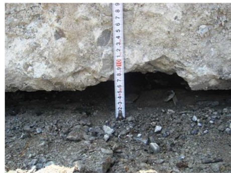
写真-3.1 K9 のコンクリート版下の空洞
