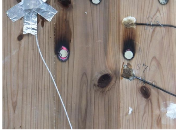
写真 2. 2. 13 ドリフトピン周囲の燃え抜け (No. 2)
