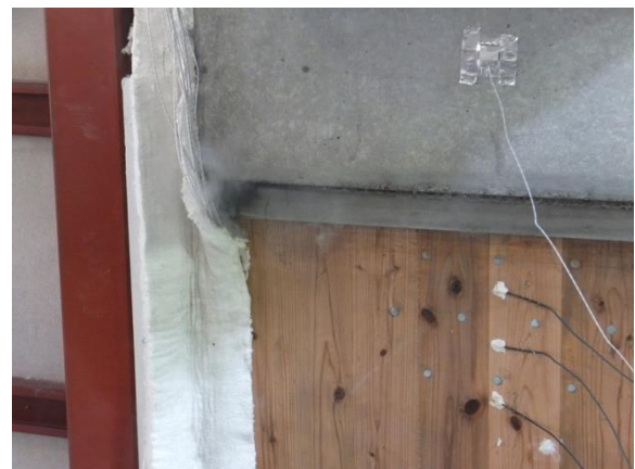
写真 2. 2. 7 無収縮モルタルのひび割れ （加熱開始後 27 分）
