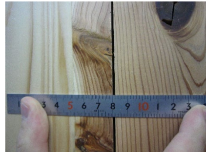
写真 4.2.3 CLT パネル間の隙間 4.2-47)
