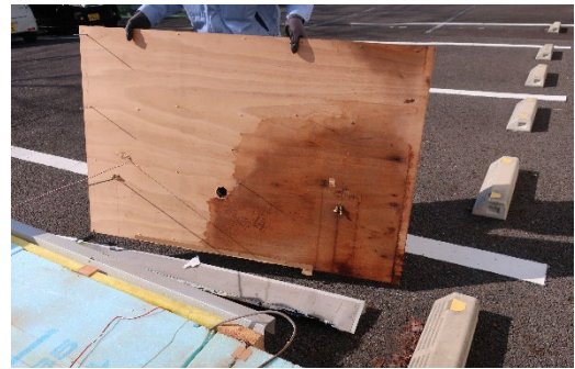
写真 4.2.2 端末金物の納まり不良による防水下地の漏水状況
