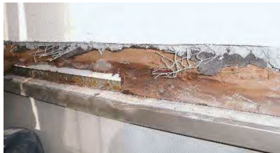
防腐・防蟻処理材と接触して腐食した土台水切り
