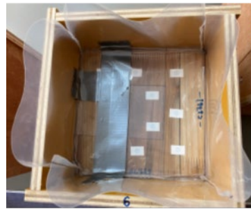
⑤ 遮水シートの型枠への固定 および防水テープの施工
