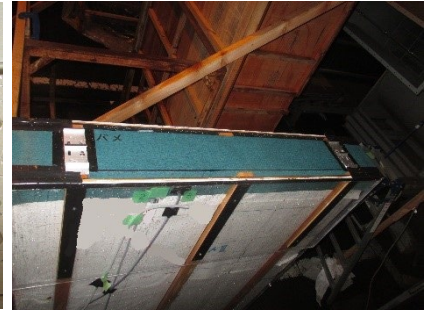
写真 2. 2. 11 手すり上面の付着水
