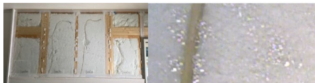
写真 2.4.2 可視化実験対象部位と結露状況の例
