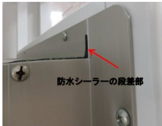
写真 2.1.7 アルミサッシのシーラーによる段差
