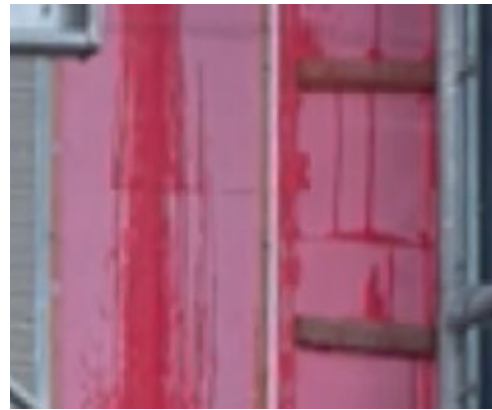
縦胴縁 横胴縁 注水実験による浸入水の滞留状況
