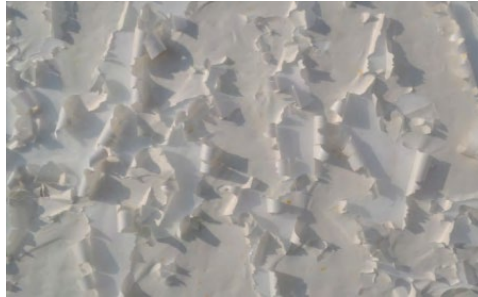
透湿防水シートの劣化状況
