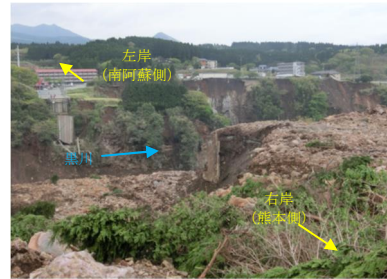
(b) A1 橋台背面・A2 橋台側左岸の落橋
