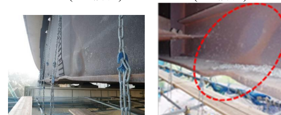
写真-3.3 主桁径間部の変形 (P1-P2径間)
