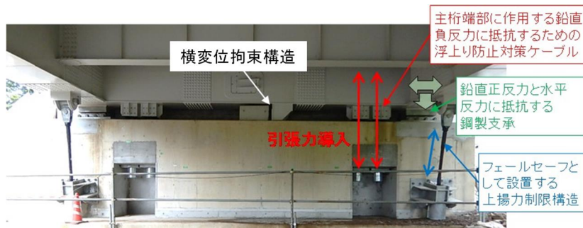
写真-4.2 機能分離型支承構造と支承の破壊を想定したフェールセーフ構造
