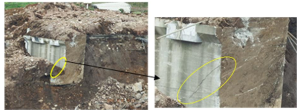
(c) A1 橋台の残存状況と橋台背面の地山の崩落状況
