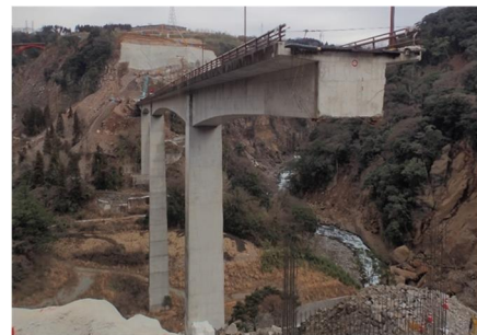
写真-6.2 橋台の鉛直支持機能を失っても自立可能な構造特性であった阿蘇長陽大橋 (A1橋台撤去後に撮影)
