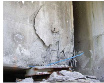
写真-5.5 A2橋台側の支点直上部の損傷
