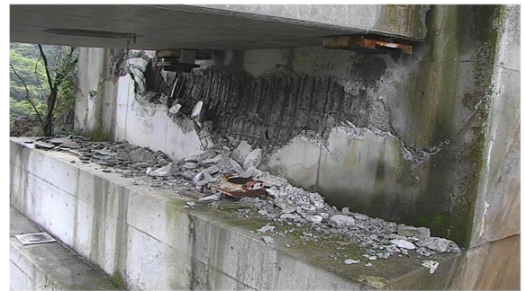
写真-5.2 A1 橋台の支承部の損傷状況
