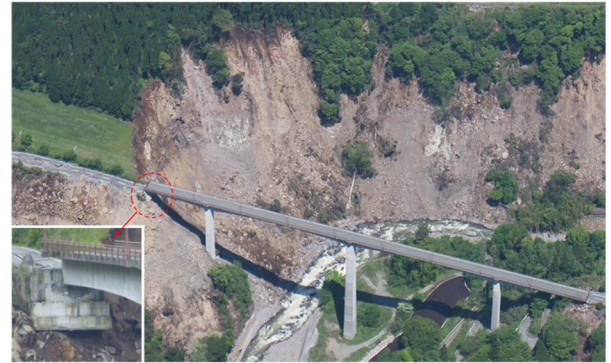
写真-5.1 阿蘇長陽大橋の周辺斜面の変状と A1 橋台の沈下
