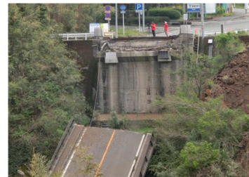
(d) A2 橋台の残存状況と上部構造の落下状況 写真-6.1 阿蘇大橋被災状況 1)
