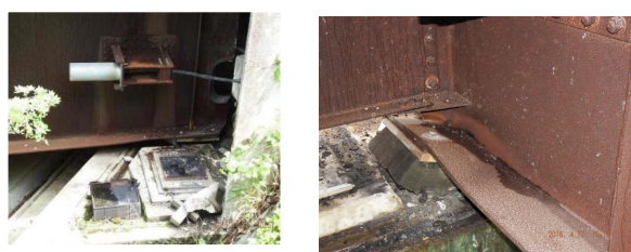
写真-3.1 支承の破断 (A2橋台) 写真-3.2 主桁支点部の変形 (A1橋台)
