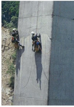
写真-5.3 近接目視による調査
