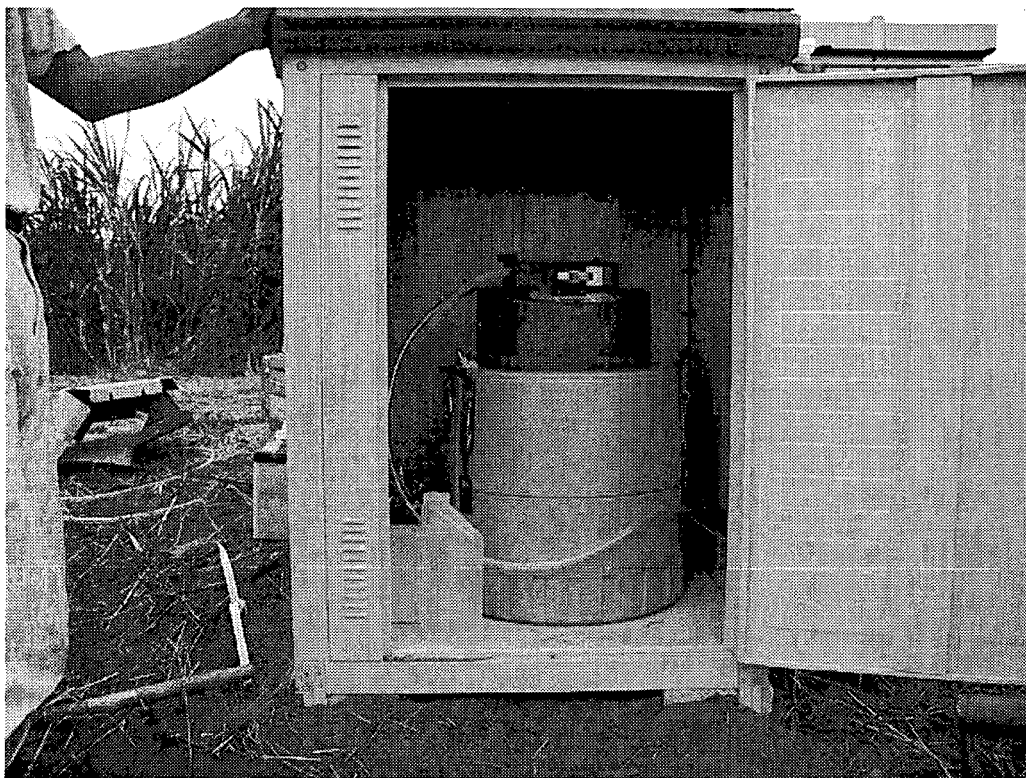
写真-2.2.3 自動採水器設置状況
