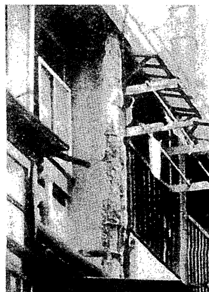
写真7(左):はりのかぶりコンクリートが剥落し錆びた鉄筋が露出している。
