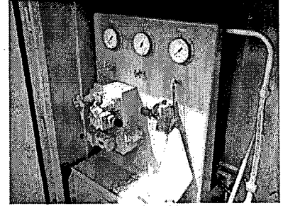
盤内油圧機器
