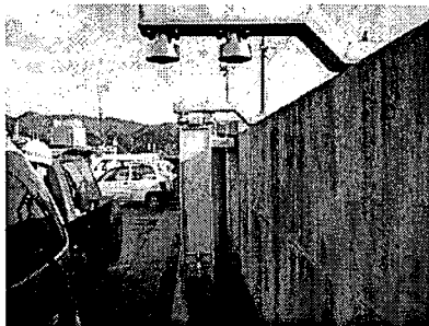
閉状態-港湾側
