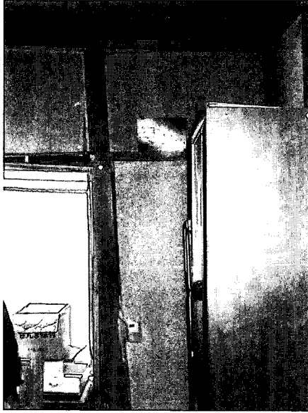
写真 10.53 内部 (柱と壁に隙間)
