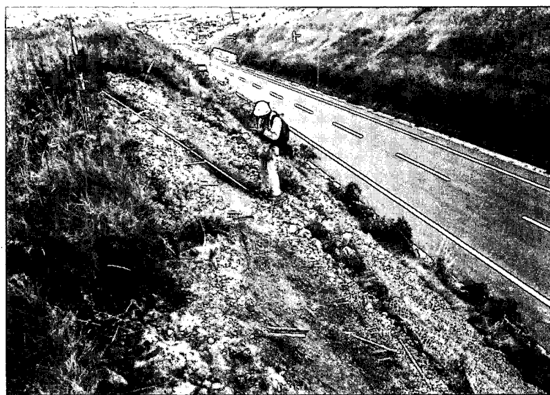
写真 9.3.9 海側切土のり面の崩壊 表層がずり落ち、挿し鉄筋が残留する。
