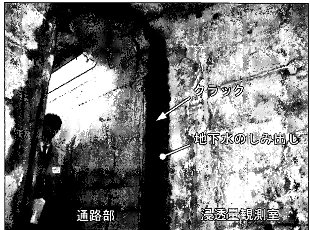
写真 8.14 三石ダムの浸透流観測室壁面のクラック状況
