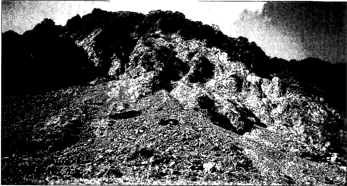
写真 9.3.3 国道 336 号線えりも町（岬第二覆道）の岩盤斜面崩壊
