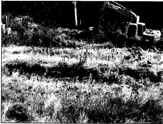
写真9.2.7 亀裂が発生した南側のり面
