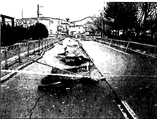
写真 6.17 阿寒町 中央地区の地盤沈下
