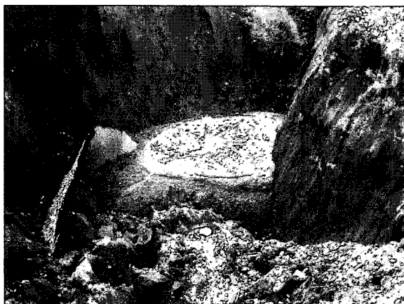
写真 7.3 旧堤盛土の亀裂内の噴砂 (十勝川右岸 3.5k 付近)
