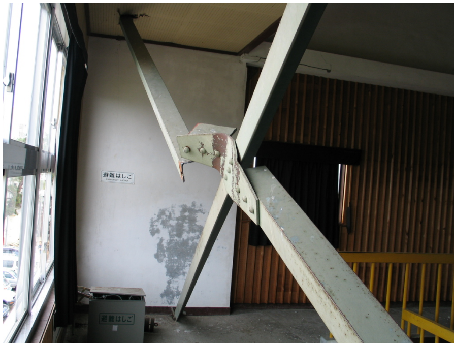
写真 G10.4 鉄骨造建築物の被害（ブレースの破断）
