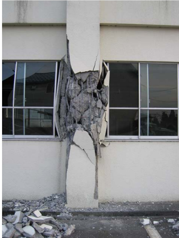
写真 G10.3 鉄筋コンクリート造建築物の被害（短柱のせん断破壊）
