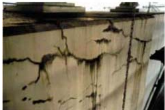
図-1 アルカリ骨材反応による損傷状況
