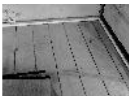
図 14 畳下地の荒板の隙間
