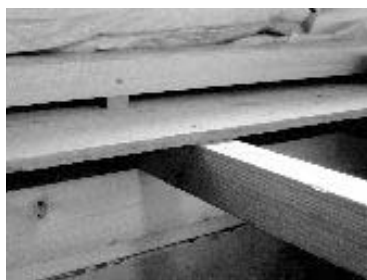
図 15 荒板と敷居の隙間
