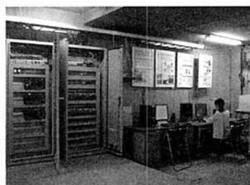
制御室（制御盤、制御用PC）
