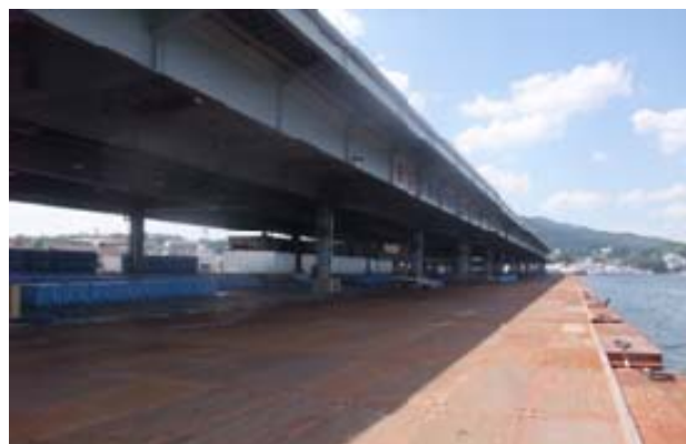
写真-8 仮設の嵩上げ工事により再開した魚市場（2011.7.17筆者撮影）
