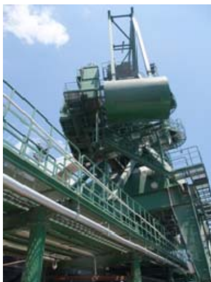
写真-1 被災してアームをもぎ取られたアンローダー (東北グリーンターミナル, 2011.5.18筆者撮影)
