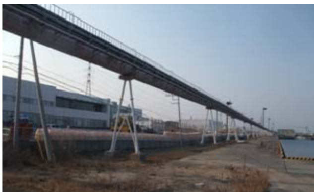
写真-15 液状化被害を受けた常陸那珂港 (2011.3.30筆者撮影)
