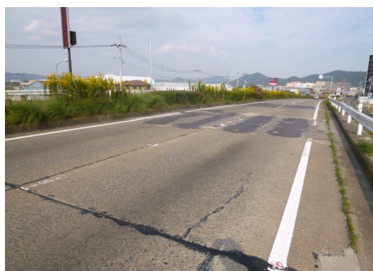
②縦ひび割れ
