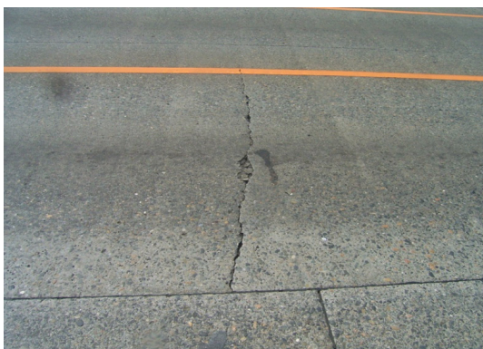
①横ひび割れ
