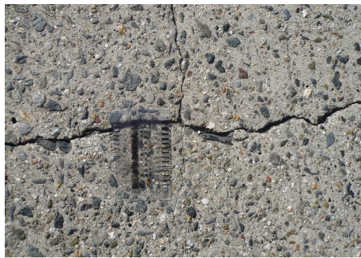
③ひび割れ幅が大きい
