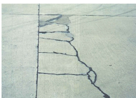
④ダウエルバー設置不良によるひび割れ 1)
