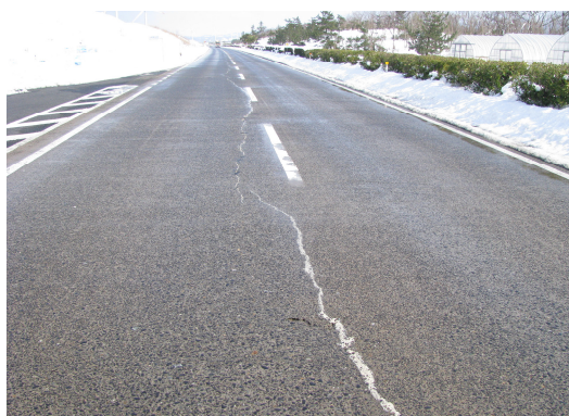
⑤縦目地がない舗装における縦ひび割れ
