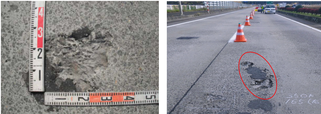
写真 2.10 路面部のポットホールの例 (黒く見える部分はアスファルトによる補修跡)
