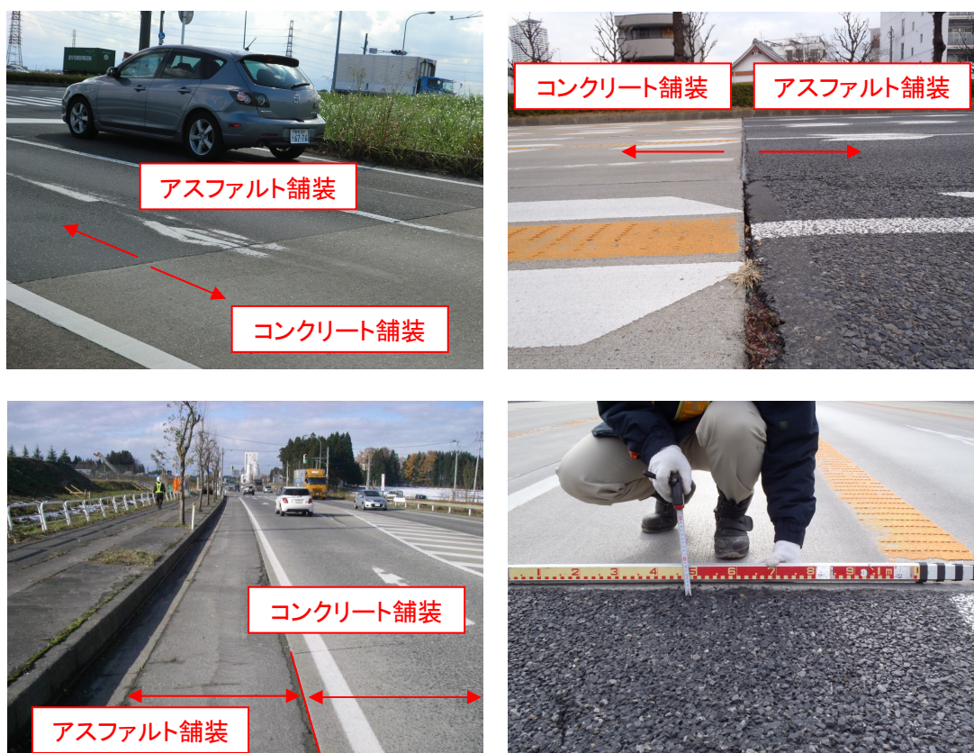
写真 2.17 アスファルト舗装との継目部の段差・開きの例
