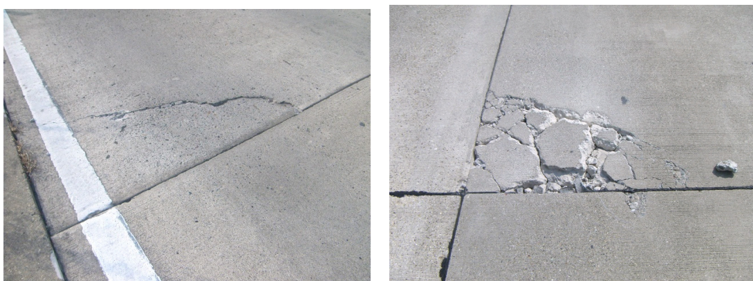
写真 2.13 隅角部のひび割れ・角欠けの例
