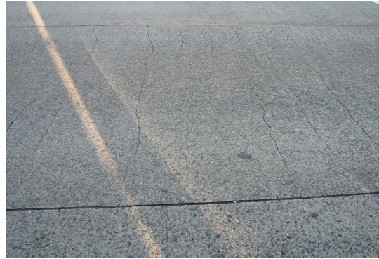
②ひび割れ間隔が不規則
