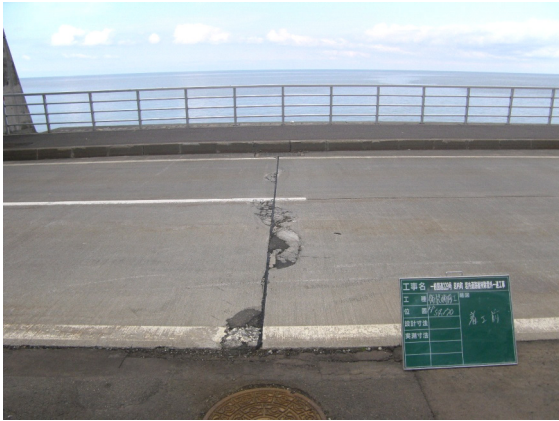
(収縮目地部の角欠け)
