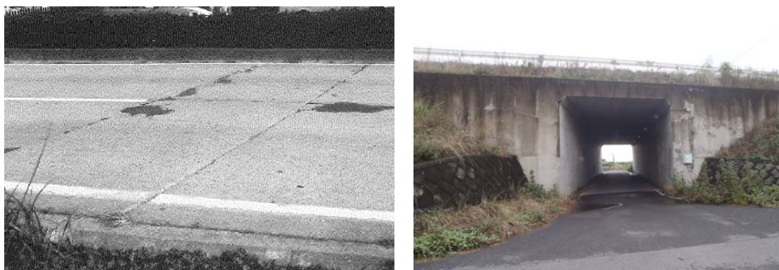
写真 3.16 地下埋設構造物周辺のひび割れ・段差の例 2)
