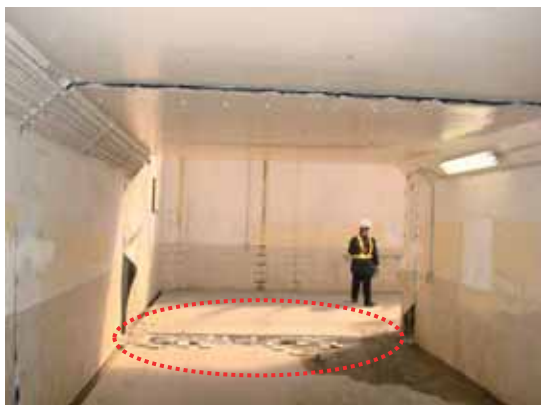
写真-5.8.2 接続部の損傷状況
