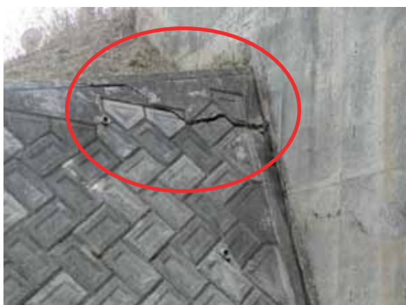
写真-5.5.3 カルバートと接する堤体コンクリートのひび割れ、沈下
