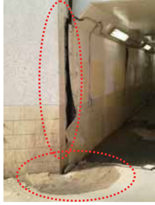
写真-5.8.4 可とう部保護板破損と継目からの土の流出
