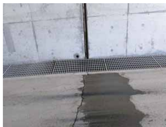
写真-5.2.4 幅約 5.5m のカルバート内の目地開き(約 25mm)及び路面のひび割れ
