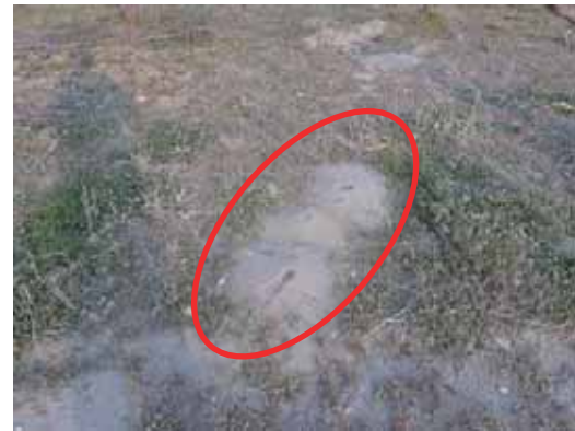
写真-5.13.4 盛土周辺の噴砂
