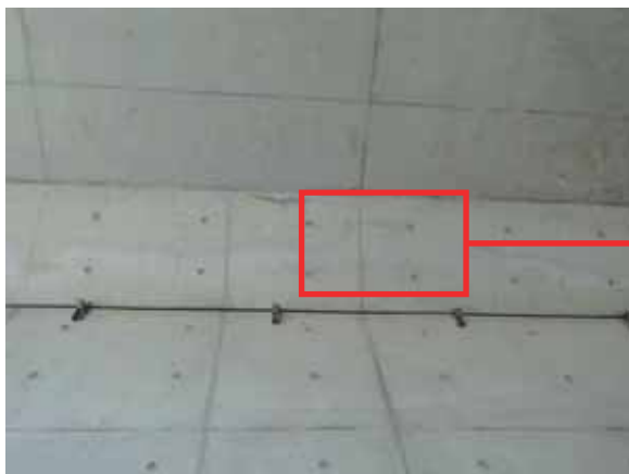
写真-5.3.3 側壁～頂版接合部のひび割れ
