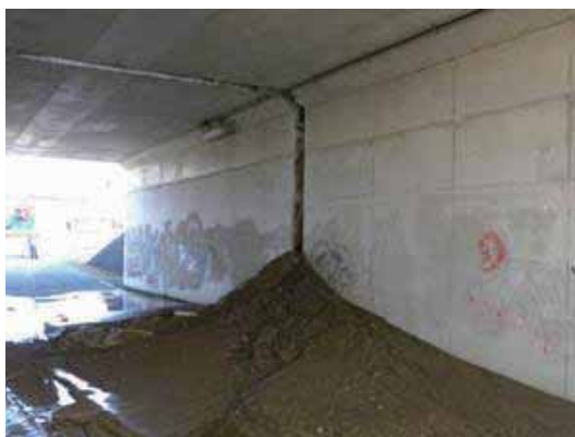
(a) 縦断構造継手部からの土砂の流出
