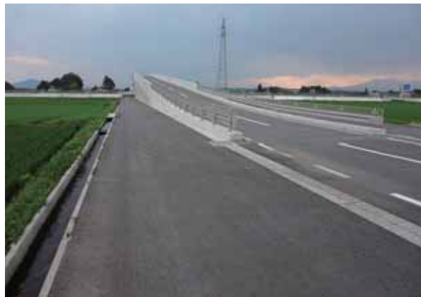
写真-5.9.5 オーバーパスの路面状況
