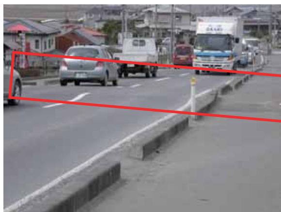
写真-5.5.2 カルバート上部の路面段差
