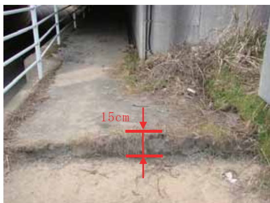
写真-5.7.3 歩道舗装面の段差状況
