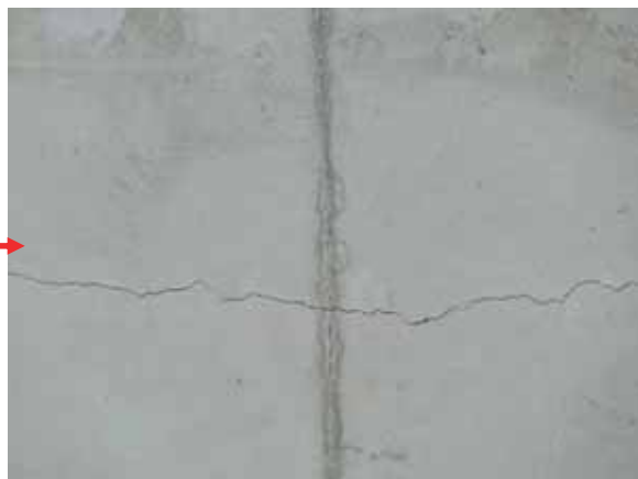
写真-5.3.4 側壁～頂版接合部のひび割れ(拡大)
