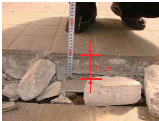
写真-5.8.3 接続部の段差
