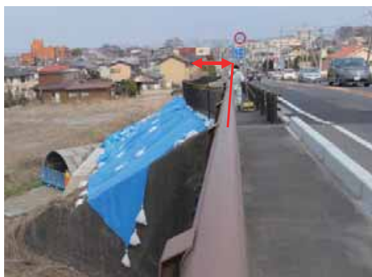
写真-5.11.3 鋼製コルゲート上部盛土の崩れ: 歩道柵が大きくはらみだしている
