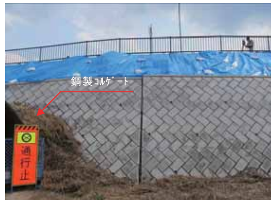
写真-5.11.4 コルゲート周囲のブロック積のずれ、沈下
