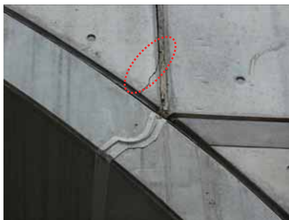
写真-5.6.3 補強土壁 (西側) のひび割れ
