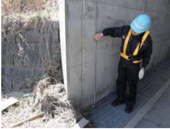
写真-5.2.5 幅約 2.5m のカルバート内の 津波の痕跡の確認(高さ約 1m)
