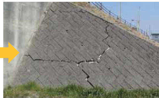
(b) 擁壁部の損傷状況
