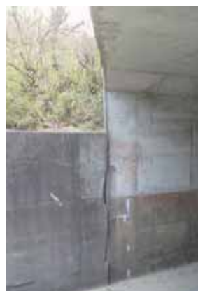
写真-5.7.4 ボックスと擁壁接続部のずれ
