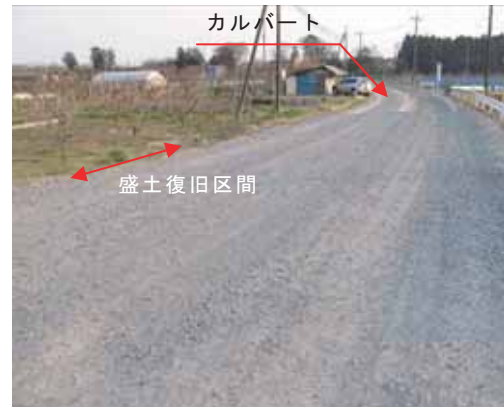
写真-5.13.2 カルバートと崩れた盛土箇所との位置関係
