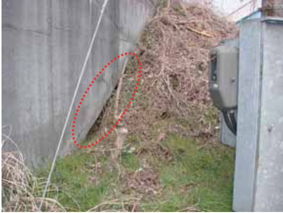
写真-5.7.5 ボックス背面盛土の沈下状況
