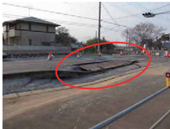
写真-5.12.2 鋼製コルゲート上の路面の変状
