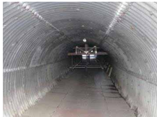
写真-5.11.2 鋼製コルゲート内部の状況: 変形が生じ、支保工で支え
