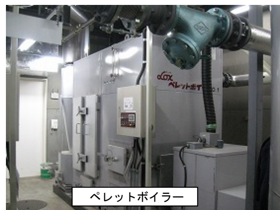
図 4.3-26 ペレットボイラー
