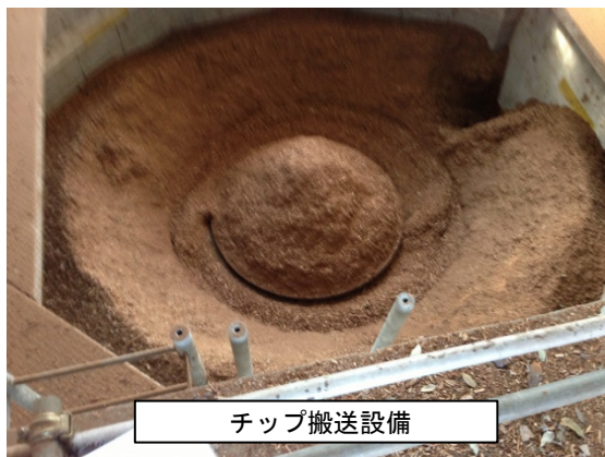
図 4.3-9 チップ搬送設備(ロータリーアーム式)
