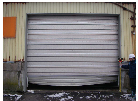
(2) ロールシャッターの被害例
