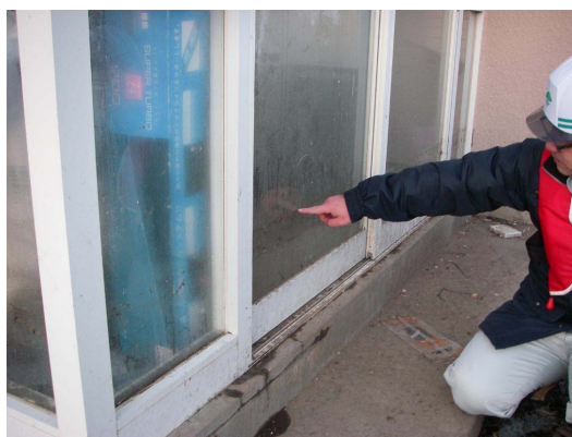
(1) 家屋の浸水痕跡
