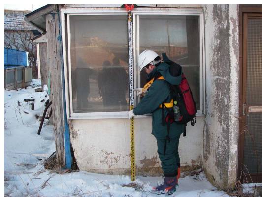
写真-4.26 地盤からの痕跡高さの測定 (地点3-f)
