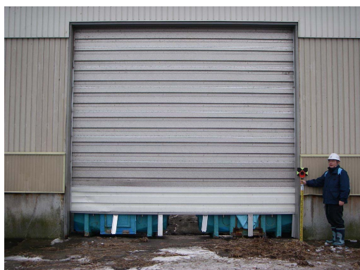
(2) ロールシャッターの被害例
