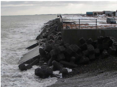
(2) 被災箇所を北側から見た状況
