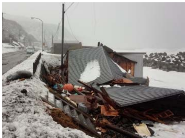
写真-2.10 越波により倒壊した昆布番屋 (羅臼町海岸町地区, 提供：羅臼町)
