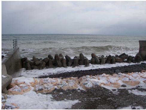
(2) 被災箇所を西側から見た状況
