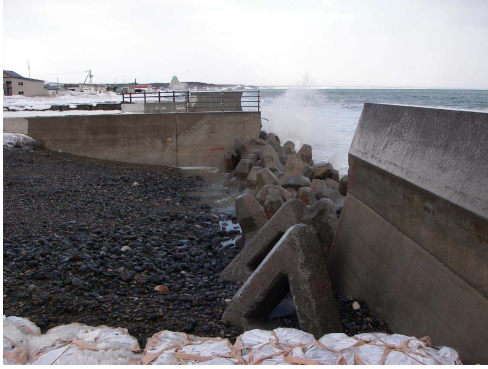
(1) 被災箇所を南側から見た状況
