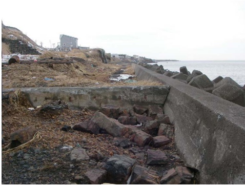
写真-4.17 岬町地区護岸（地点2-e）
