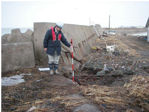
写真-4.18 地盤の洗掘（地点2-f）
