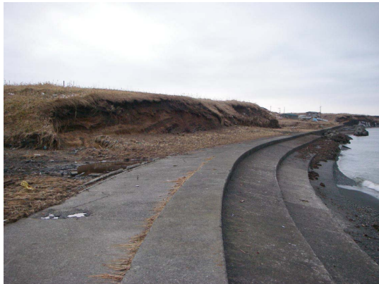
写真-4.31 背後の小丘が削られて崖状になった状況 (地点4-b)
