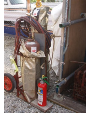
写真-4.2.3 ガスボンベの例
