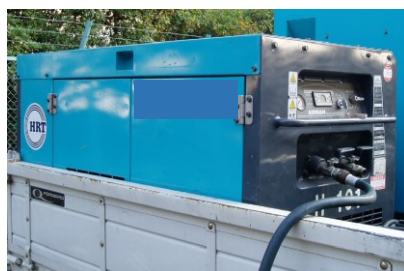
写真-3.2.2 コンプレッサーの例
