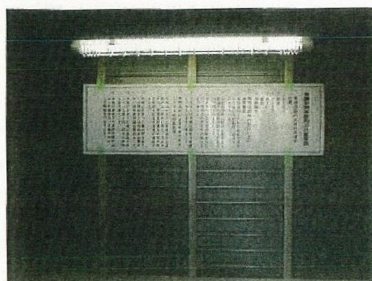
防爆型照明設備
