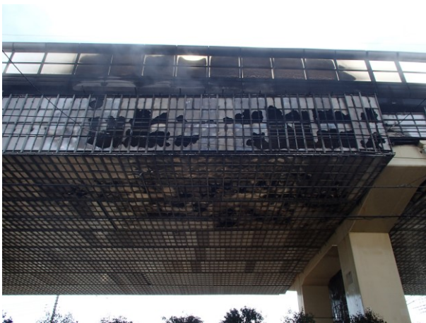
写真-4.3.4 金属製パネル式足場の焼損例
