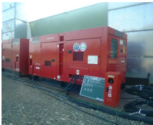
写真-3.2.1 発電機の例
