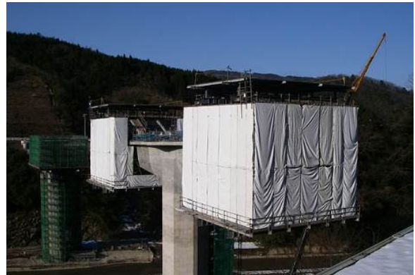
写真-5.2.6 防護設備の一例
