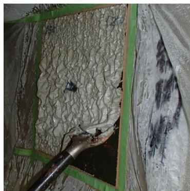
塗装剥離状況
