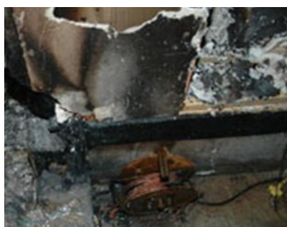
写真-3.2.3 コードリールから出火した事例
