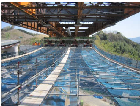
写真-3.3.9 安全ネットの例
