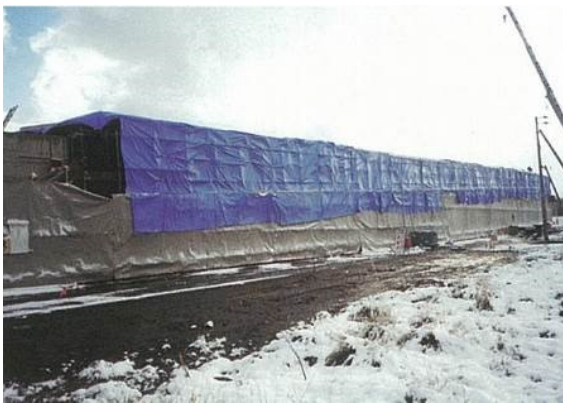
写真-5.2.1 冬季養生用上屋
