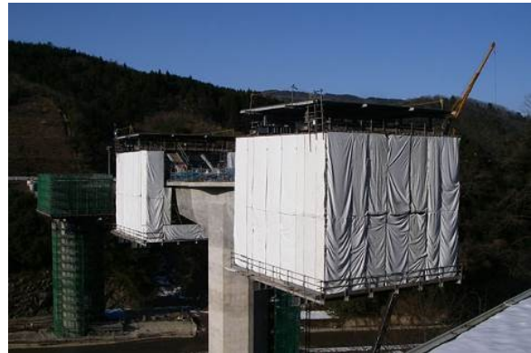
写真-5.2.6 防護設備の一例
