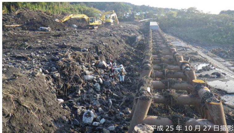
写真 3.2.7 捕捉された土石流の堆積物
