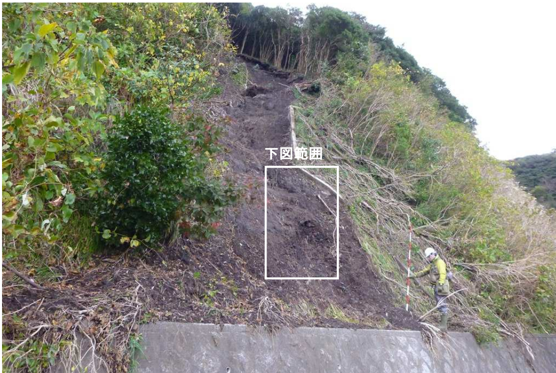
写真 3.1.3 土層観察箇所①の崩壊地全景
