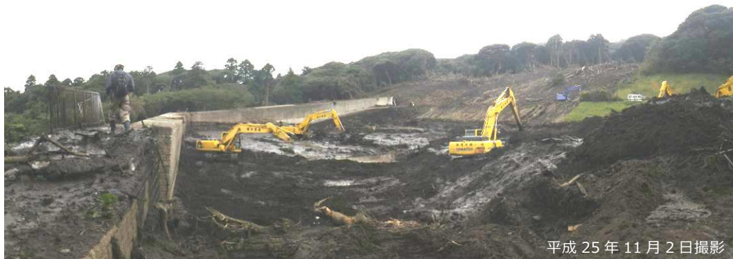
写真 3.2.23 長沢砂防堰堤での土砂・流木の捕捉
