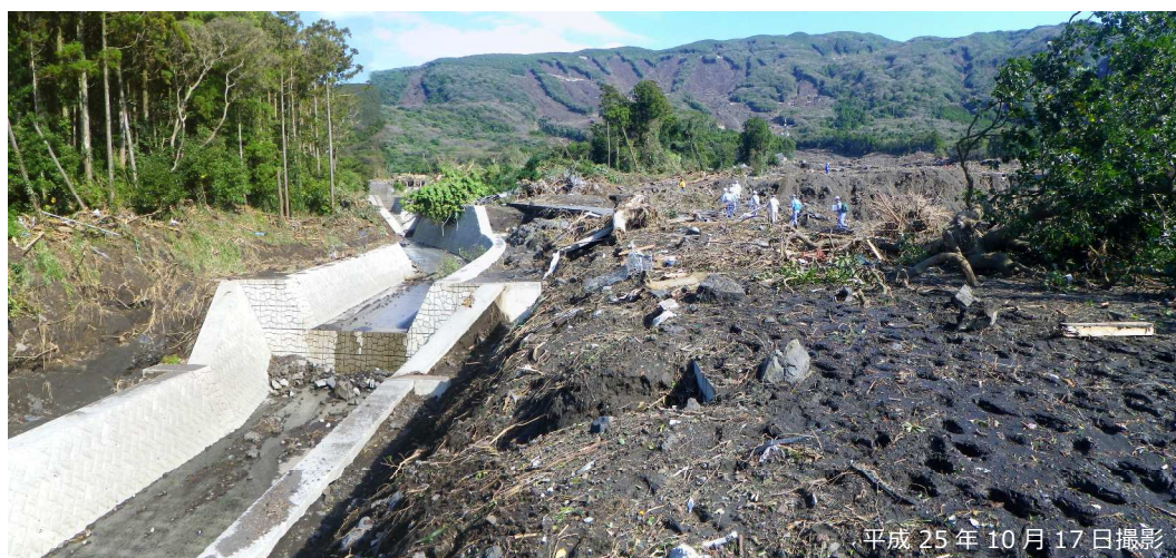
写真 3.2.10 溪流保全工への左岸側からの土石流流入状況
