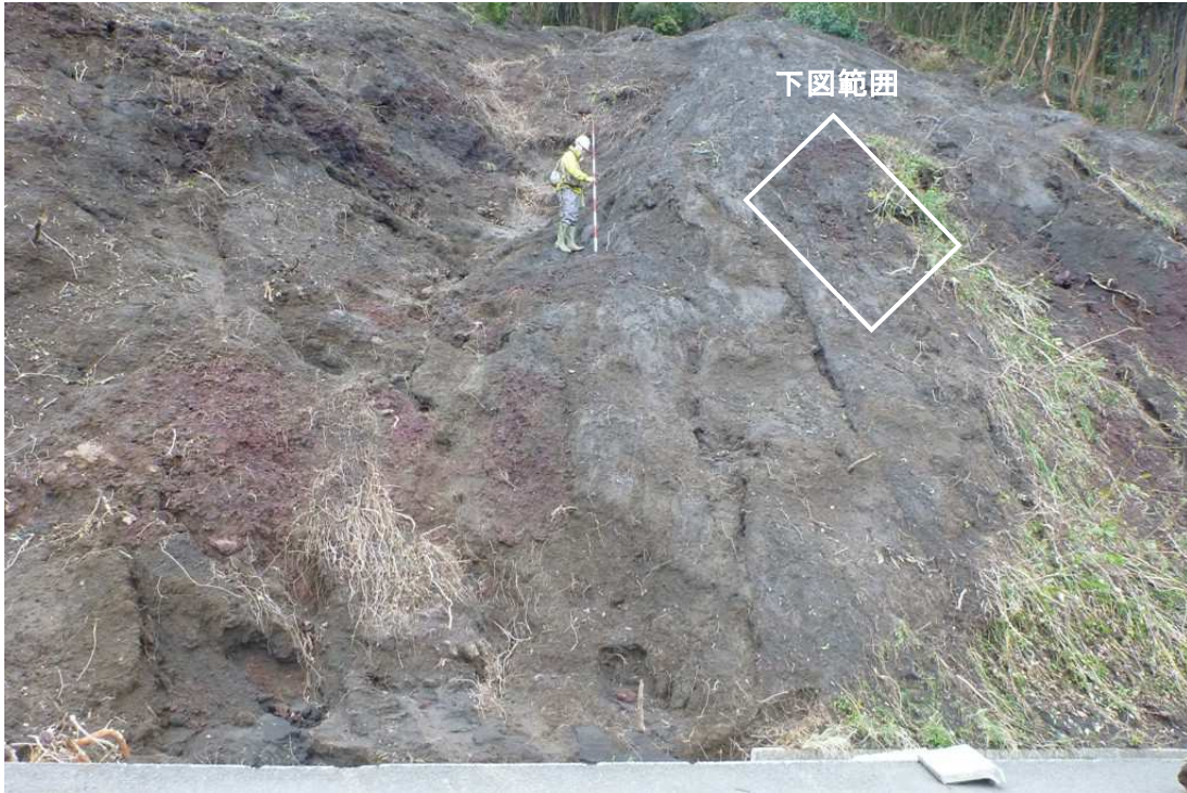
写真 3.1.7 土層観察箇所③の崩壊地全景
