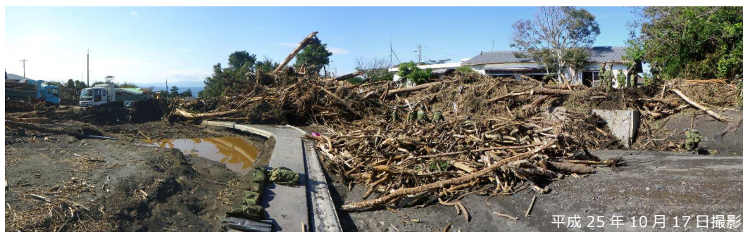
写真 3.2.11 橋梁部の閉塞に伴う溪流保全工内の土砂・流木堆積状況
