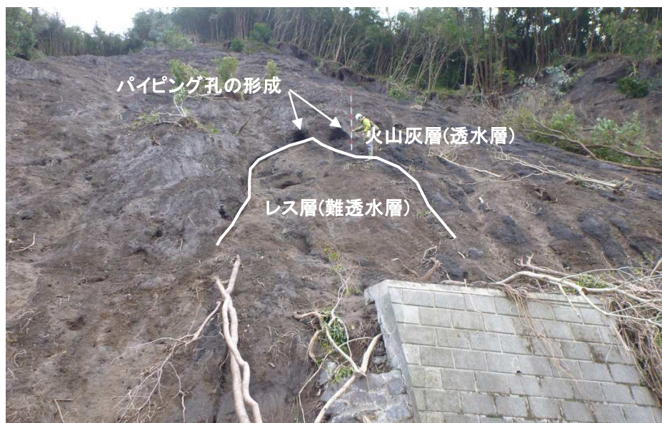
写真 3.1.2 大金沢源頭部のパイピング発生状況
