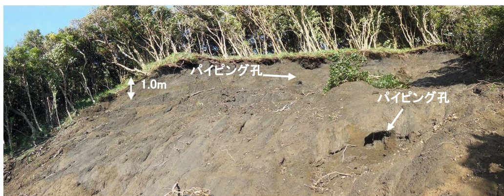
写真 3.1.16 崩壊地②の全景
