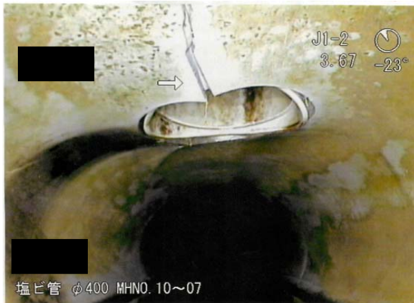
図 2-36 管径φ400：破損の直視画像
