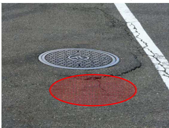
図 2-40 偏平箇所の地上状況
