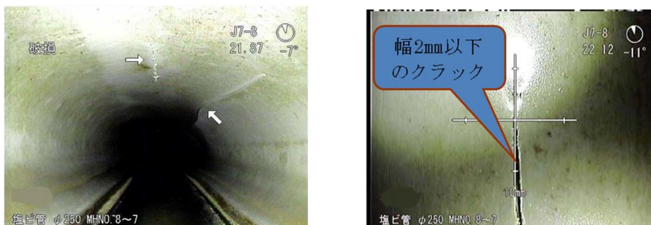
図 3-48 破損（軸方向クラック） 左図：直視画像、右図：側視画像
