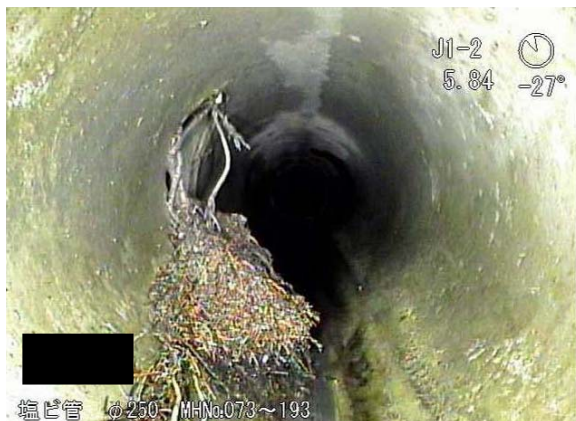
図 2-46 樹木根侵入の直視画像
