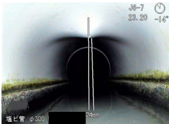
写真－3 変形の事例
