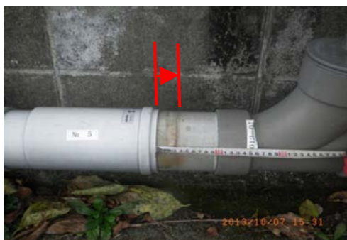
写真 1 伸縮による継手部のズレ
