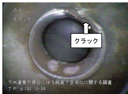
写真2 下水道管の劣化状態①
