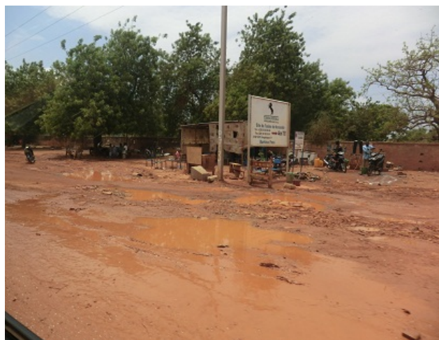
写真5 現地訪問期間中(2014年4月)の降雨後の道路の様子。短時間の降雨であったが、浸透せず水たまりとなっていた。
