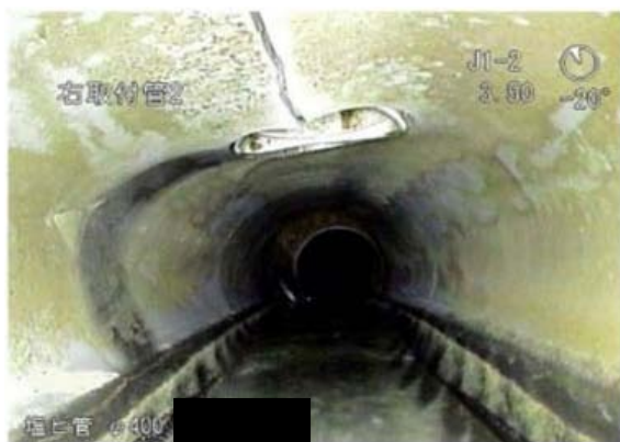
写真－1 破損の事例
