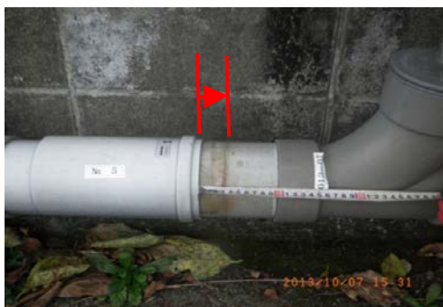
写真 1 伸縮による継手部のズレ
