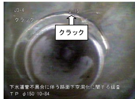
写真3 下水道管の劣化状態②
