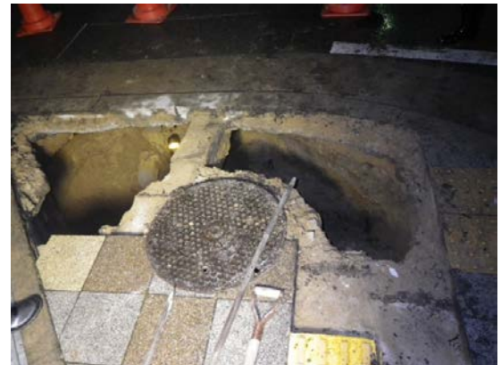
写真1 歩道陥没による被害例
