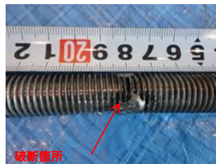
写真-3.2.2 破断ボルト（点付け溶接）
