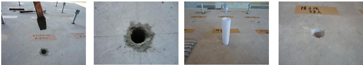
写真-3.2.12 セメントペースト塗布状況 写真-3.2.13 セメントペースト塗布完了 写真-3.2.14 障子紙設置状況 写真-3.2.15 障子紙設置完了
