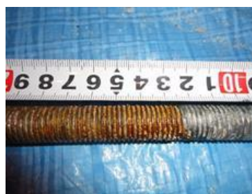
写真-3.2.17 腐食状況
