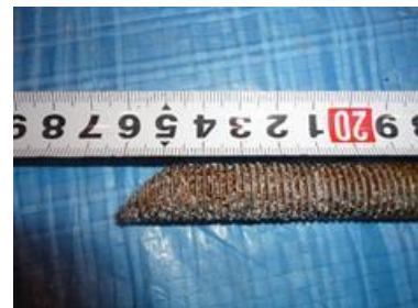
写真-3.2.18 腐食状況
