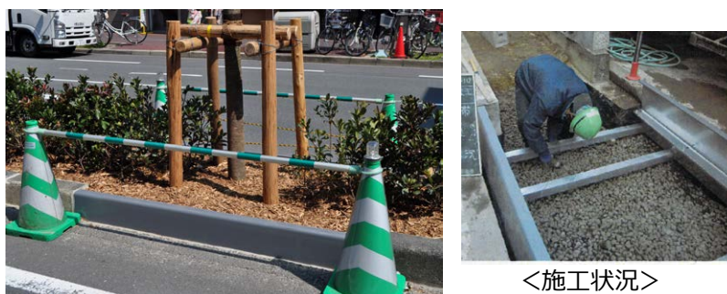
写真-3.2 根上り防止対策の事例：鋼製植栽帯による構造物強化 写真提供：京都市（事例集・再整備No.11）
