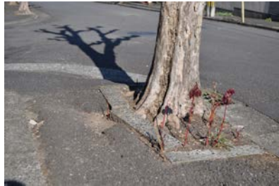
トウカエデの根上り状況
