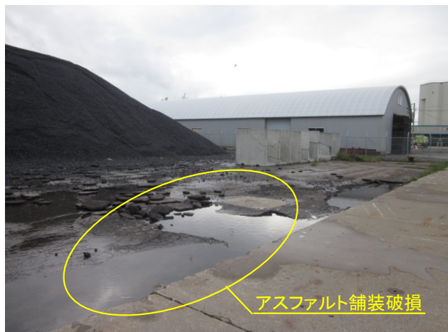
写真-4.10 網走港における浸水後の状況
