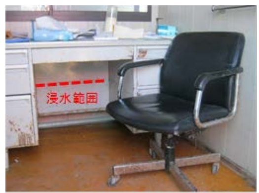
写真-2.11 西浜町③（事務所内）
