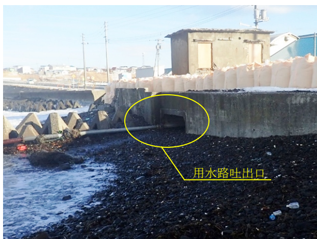
写真-4.5 浸水箇所付近の用水路吐出口(西浜町)
