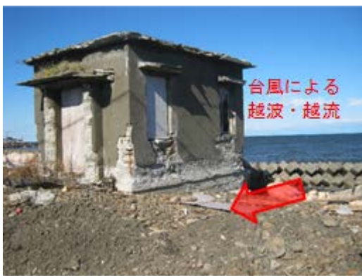
写真-2.9 西浜町①（護岸欠損箇所）
