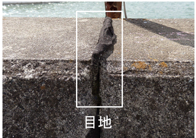
写真 1.3 護岸目地部の損傷の状況
