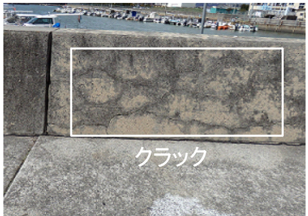
写真 1.4 護岸上部工ひび割れの状況
