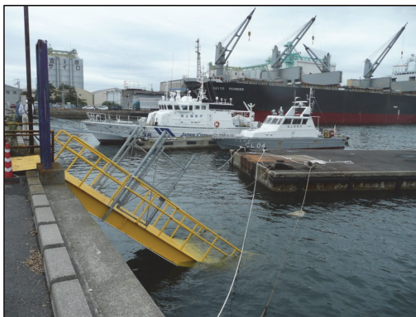
写真-6.14 被災した浮棧橋
