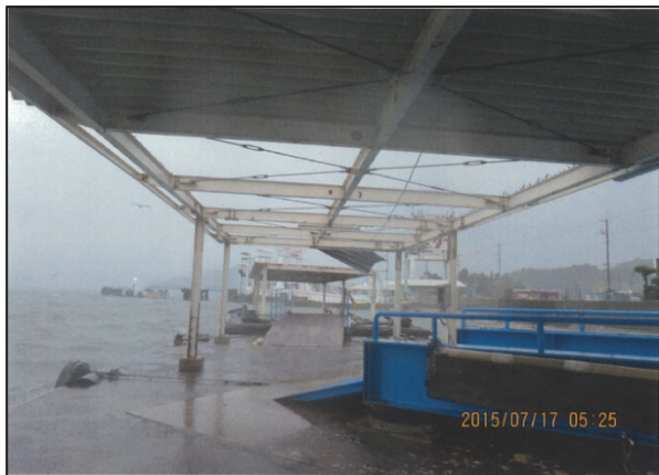
写真-6.1 被災した浮棧橋 (提供: 宇野港管理事務所)
