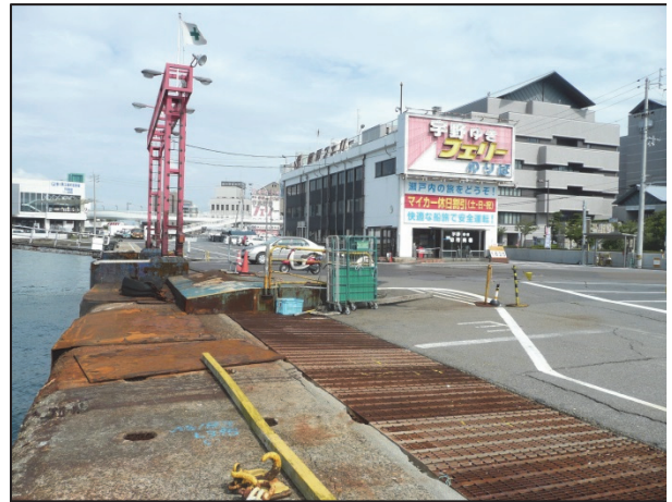
写真-6.7 浸水したフェリー乗場
